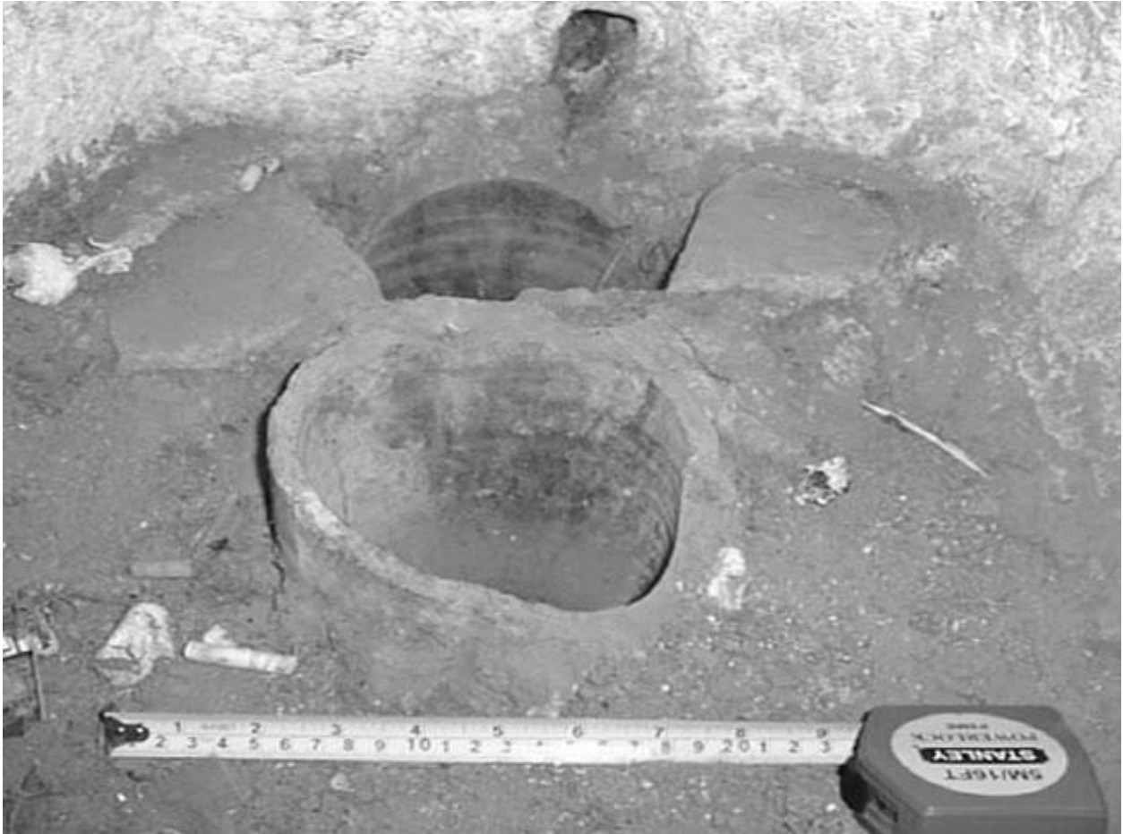
Figura 9 Parte interior de una caja de distribución de agua
